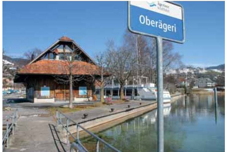
Der momentane Steg für die Kursschiffe: Er ist in schlechtem Zustand und muss ersetzt werden.
